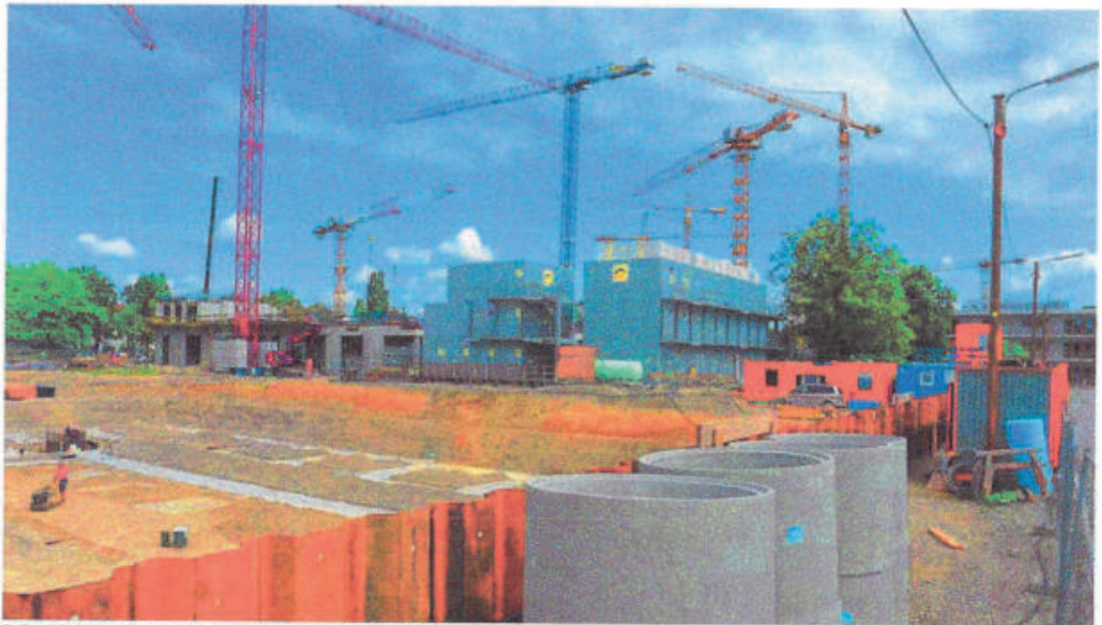
Großbaustelle: Wo heute Baucontainer drei Stockwerke hoch gestapelt stehen (Mitte), soll in drei Jahren der Maria-Niedl-Platz liegen, um den sich die Quartierszentrale des Wohngebiets Prinz-Eugen-Park, das Social- und Kulturbürgerhaus und diverse Einkaufsmöglichkeiten gruppieren werden. (Foto: Robert Haas)
